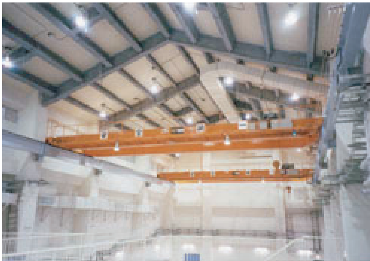
Fig. 1.10 天井巻上げ式移動クレーン :OHC ( Overhead Hoist Crane ) ( [不二工業株式会社] より転載 )
